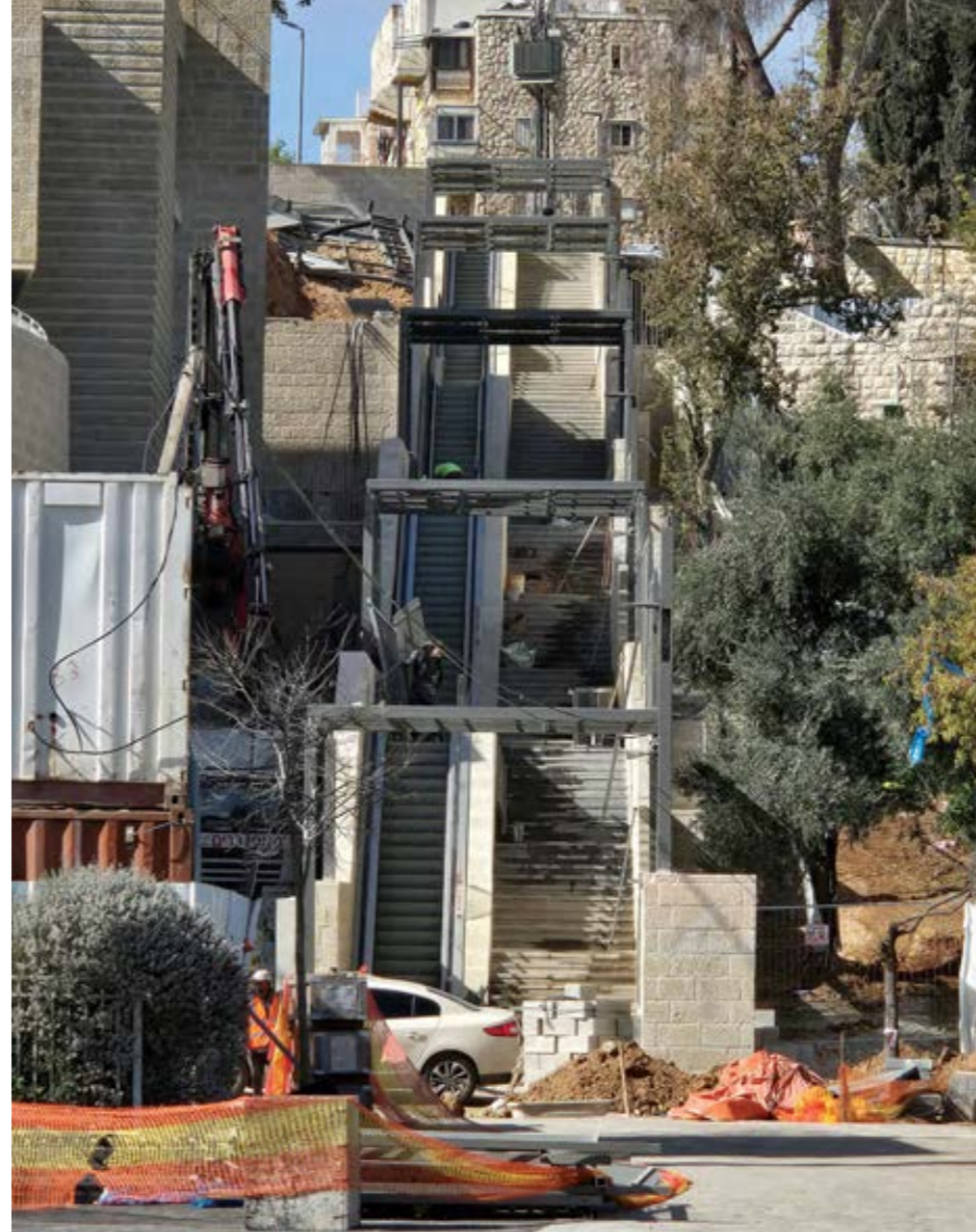
▲ מערכת דרגנועים המחברת את תחנת גבעת מרדכי במפלס נמוך עם מרכז השכונה על ראש הרכס (ארד סימון אדריכלים)
