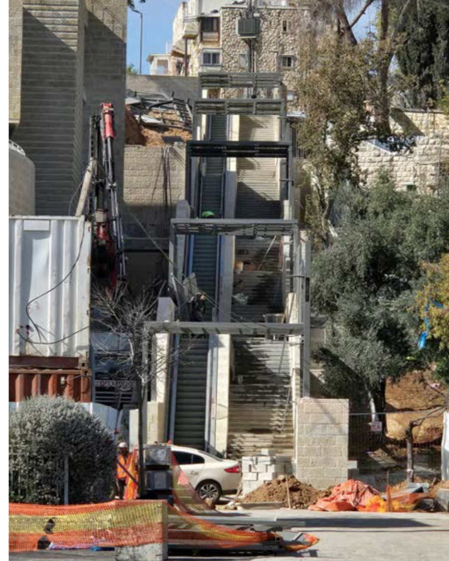
מערכת דרגנועים המחברת את תחנת גבעת מרדכי במפלס נמוך עם מרכז השכונה על ראש הרכס (ארד סימון אדריכלים)
